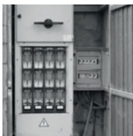
Diversos tipos de batería de condensadores de reactiva
