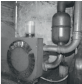
Bomba de baleiro
